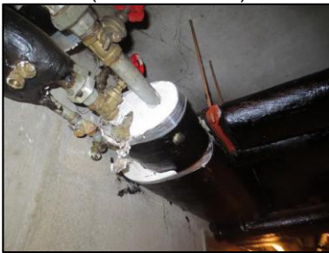
Photo N° 927 ECH-N°1 CALORIFUGEAGE --COULOIRS DE CAVES Conduits de fluide Laine minérale + enveloppe bituminée
